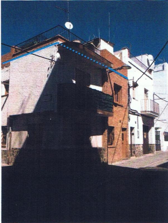
Foto 1: Detall traçat línia B.T. trenada per façana.
