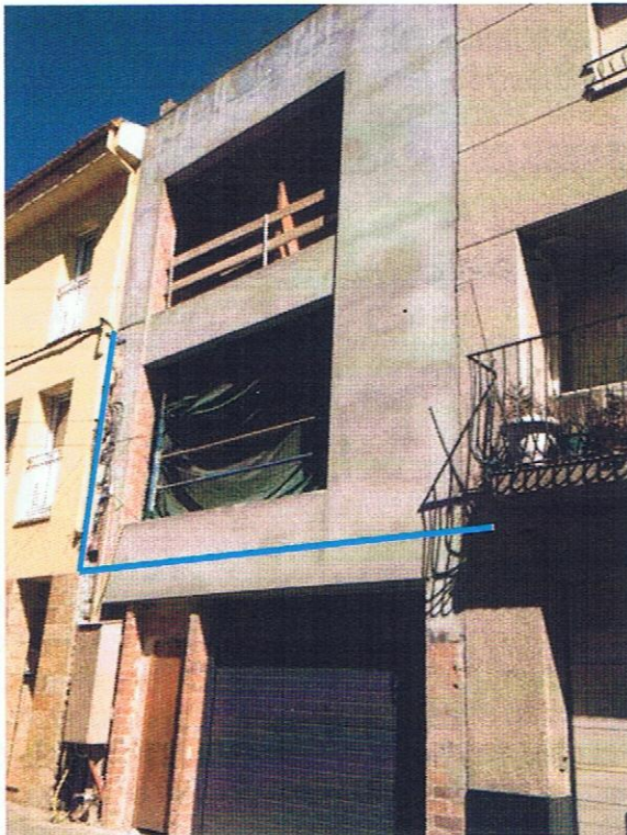
Foto 1: Detall traçat línia B.T. trenada per façana.
