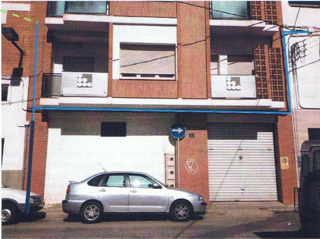
Foto - Detall conversió B.T. aèria-soterrada i traçat en façana
