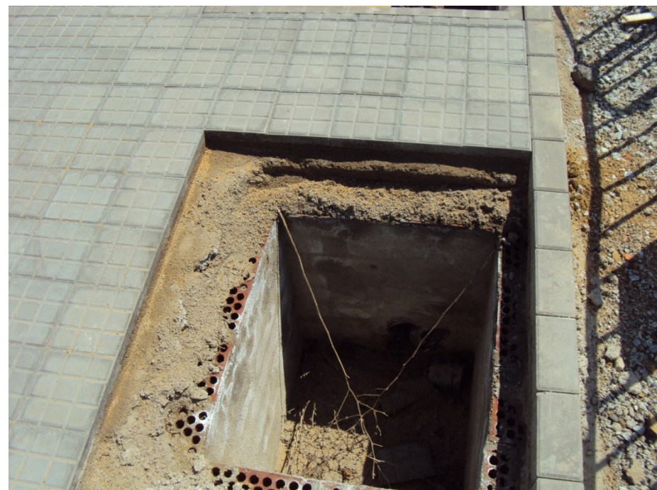
Foto núm. 23 Detall arqueta sense tapa
