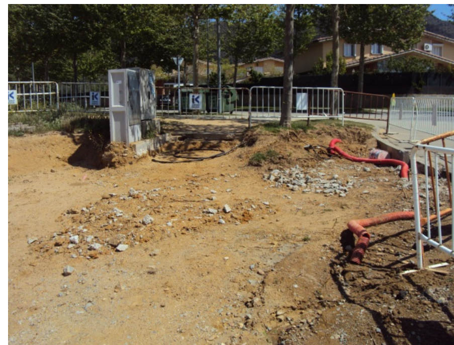
Foto núm. 14 Quadre elèctric
