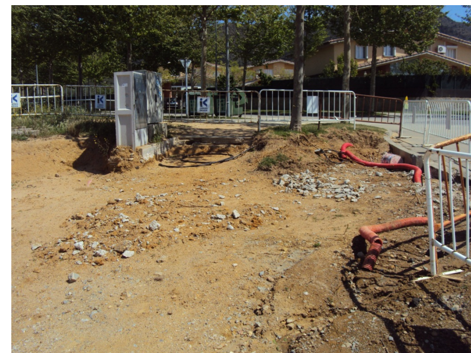
Foto núm. 28 Situació quadres existents
