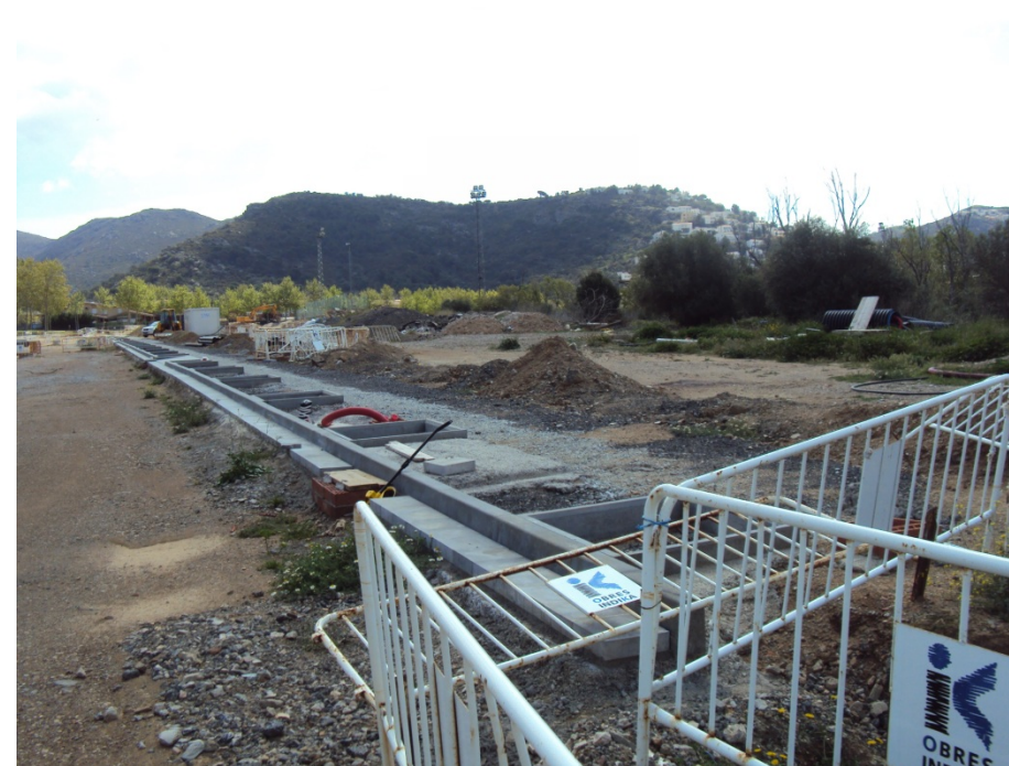
Foto núm. 22 Vorera sud
