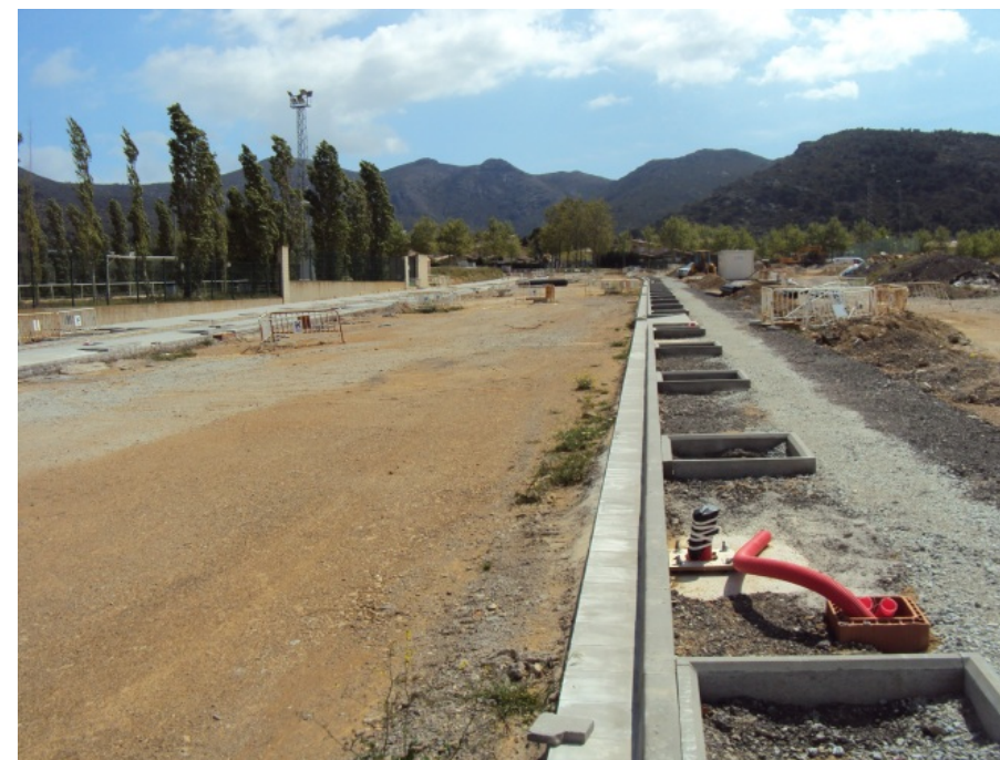
Foto núm.6 Vorera sud
