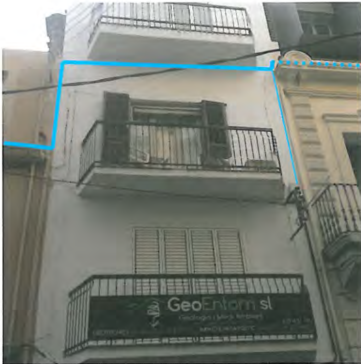
Foto - Detall traçat xarxa B.T. en façana.
