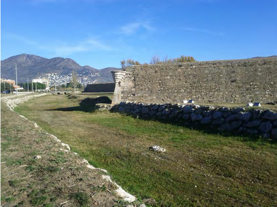
Foto 9: Vista de la punta de la muralla de la Ciutadella, que queda al mig de l'actuació. És el punt on la muralla s'acosta més a la llera de la Riera Trencada. La protecció d'escullera existent només es troba en la pròpia punta i cap a aigües avall; cap a aigües amunt ja no n'hi ha fins a l'alçada del pont de la Ronda de Circumval·lació.
