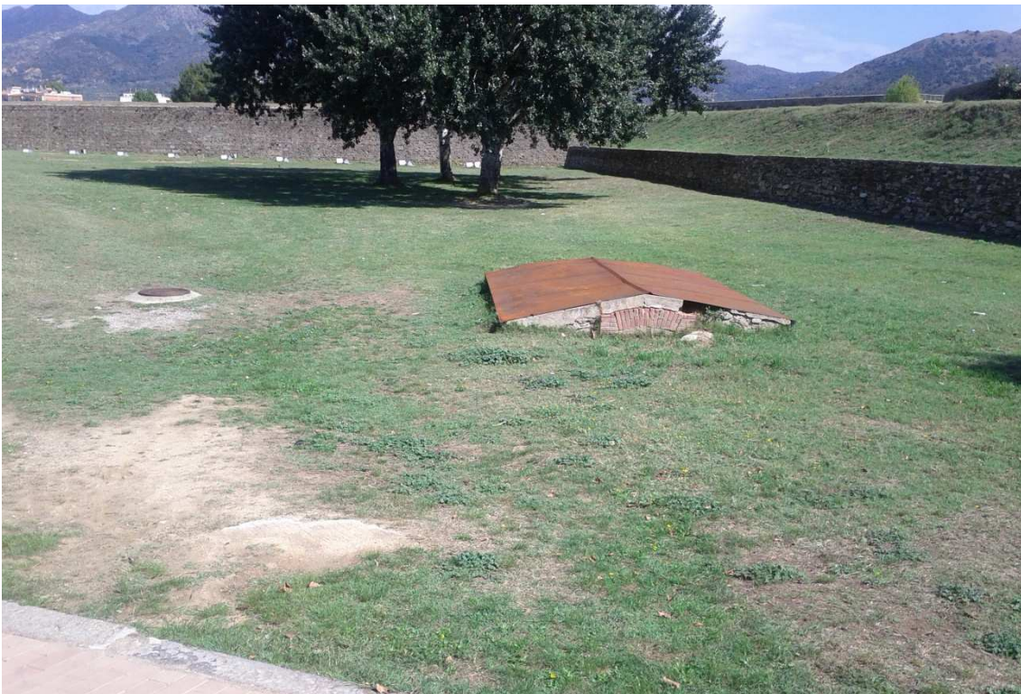
Foto 6: Vista de la coberta de la caseta de la Font de la Vituà i de la tapa de la cambra de línies de telecomunicacions.
