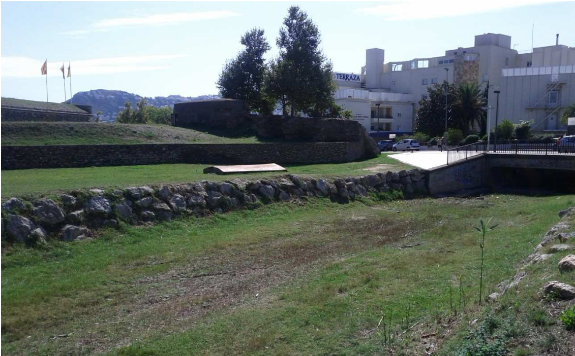
Foto 5: Vista del tram final de l'actuació des del marge dret de la riera Trencada. Al fons hi ha el pont de l'Avinguda de Rohde amb l'aleta de formigó que continua amb la protecció d'escullera. També es pot veure la coberta de la caseta de la Font de la Vituà, en la part central de la imatge.
