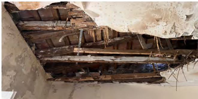
ESTAT CEL RAS ENCADELLAT DE GUIX DELS CAIRATS DEL TAULAT DE TEULES
