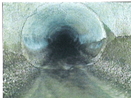
Fotografía: 12a, Nº Video: 194, 00:07:06 10m. Grieta longitudinal desde 12 hasta 12 horas. Anchura ? cm
