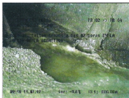
Fotografía 5a, N° Video: 194_00:00:57 0,5m, Roturas. Felan trozos a las 07 horse EN LA SALIDA DE LA ACCMETIDA
