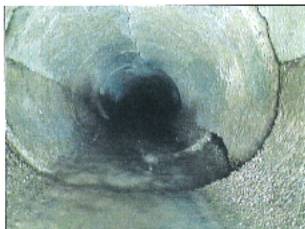
Fotografía: 11a, Nº Video: 194, 00:06:00 4m. Roturas. Falta trazo desde 04 hasta 05 horas, con el fondo visible
