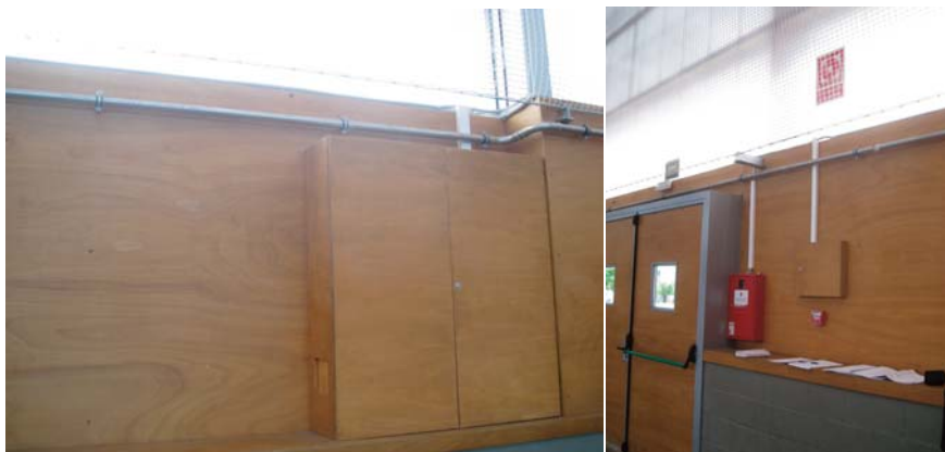
Fotografies 8.1 i 8.2. Quadre elèctric i centraleta del sistema de detecció i extinció d'incendis
