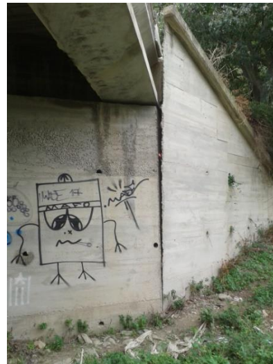
L'aleta de sortida del marge esquerre s'ha desplaçat i desploma respecte l'estrep
