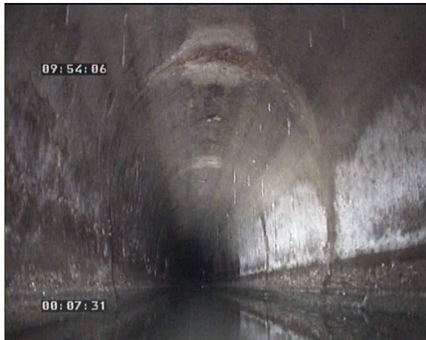
Foto: 22_1_4_16102008_095853_B.JPG 16,16m, Junta con filtraciones a la altura de la clave
