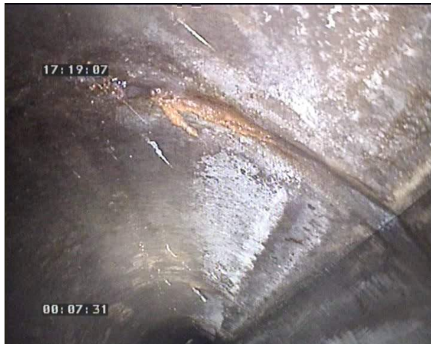
Foto: 27_1_9_16102008_172400_B.JPG 27,28m, Filtraciones por la junta
