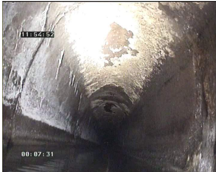
Foto: 24_1_3_16102008_115946_A.JPG 14,9m, Rotura de la junta hasta la altura de la clave
