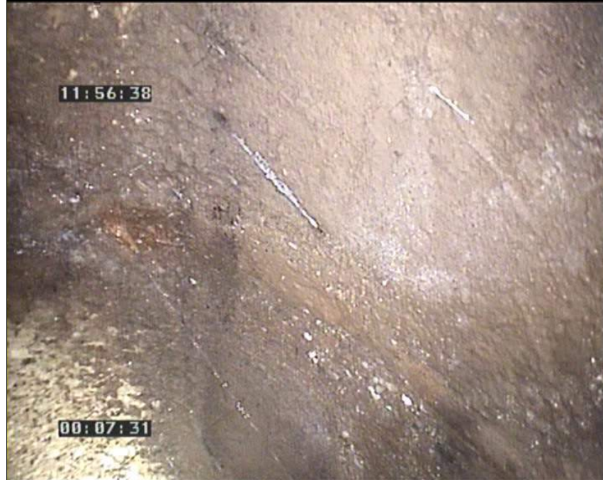
Foto: 24_1_4_16102008_120149_B.JPG 23,28m, Junta con filtraciones
