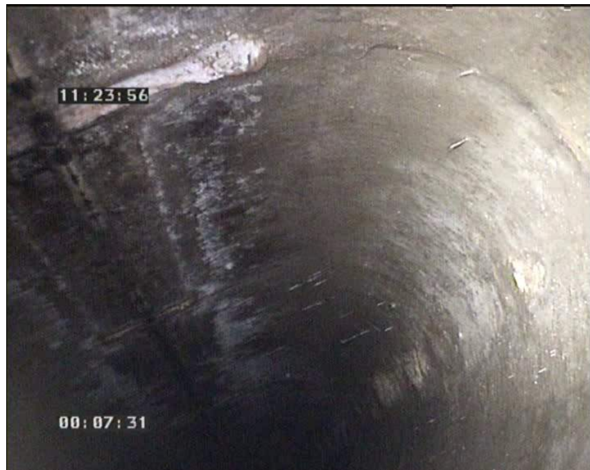
Foto: 23_1_3_16102008_112848_A.JPG 8,33m, Junta con filtraciones
