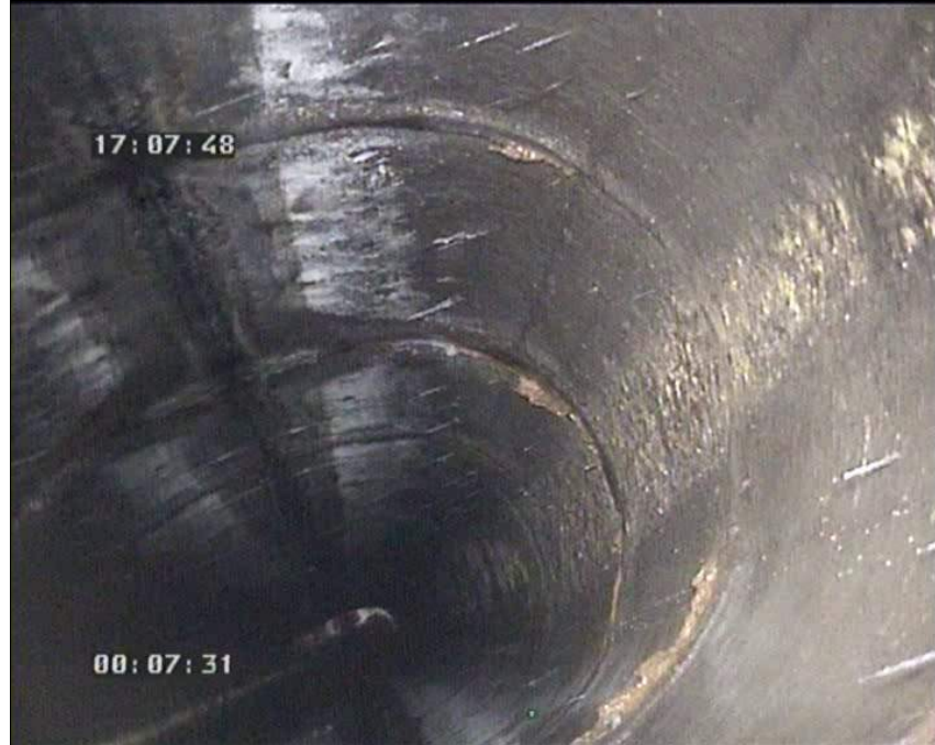
Foto: 27_1_4_16102008_171235_A.JPG 1,94m, Junta con filtraciones
