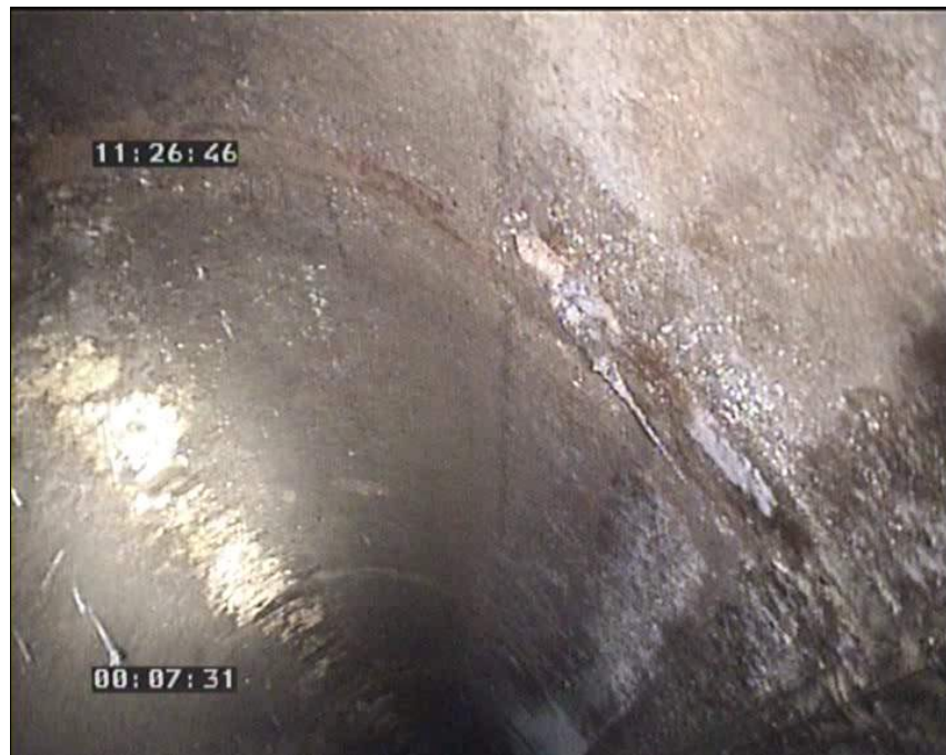
Foto: 23_1_4_16102008_113134_A.JPG 10,96m, Junta con filtraciones
