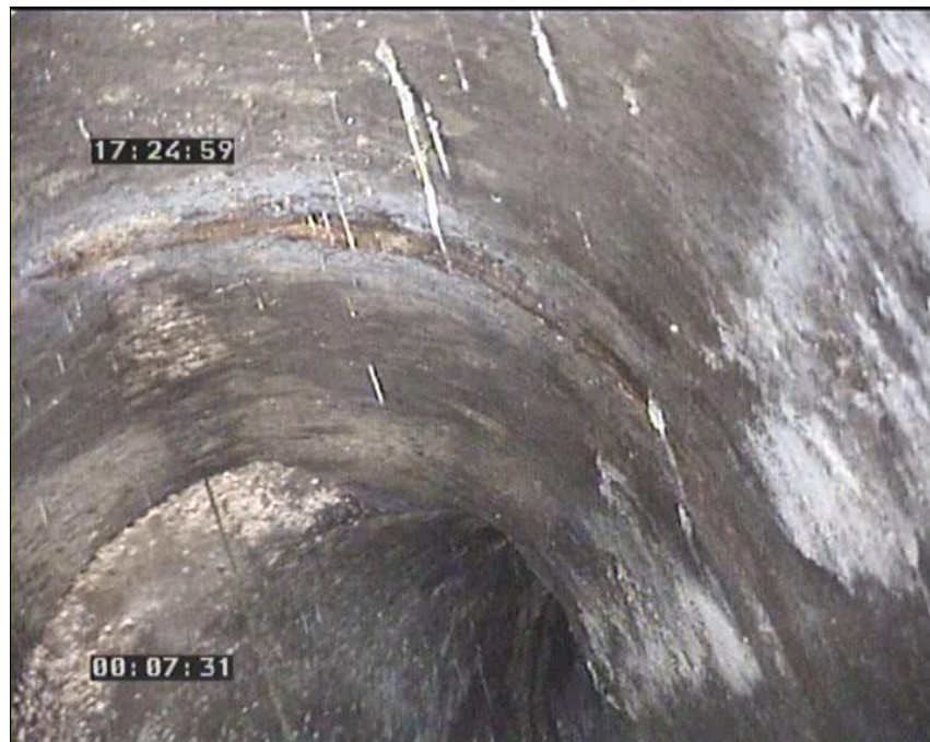
Foto: 27_1_14_16102008_172946_A.JPG 37,22m, Filtraciones por la clave
