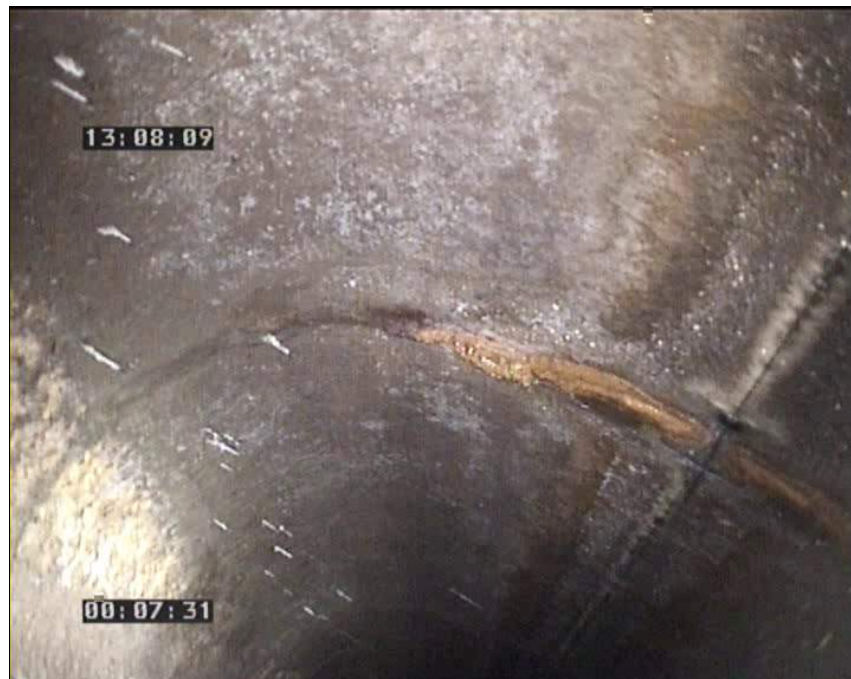
Foto: 25_1_5_16102008_131258_A.JPG 43m, Junta con filtraciones
