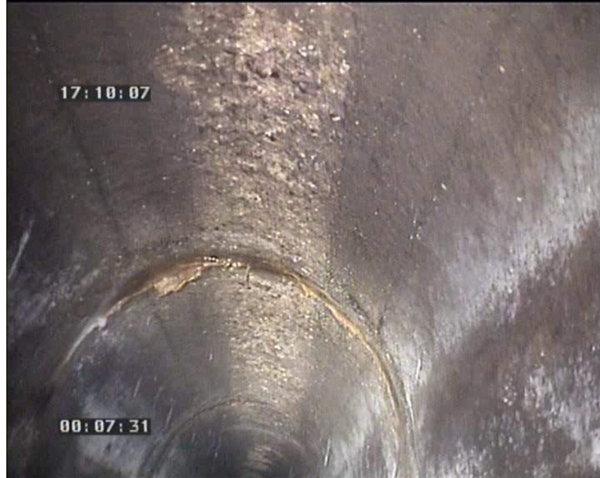
Foto: 27_1_6_16102008_171658_A.JPG 5,87m, Filtraciones por la clave
