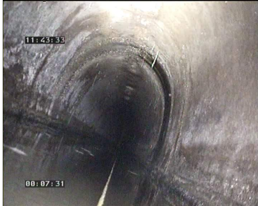
Foto: 23_1_12_16102008_114831_B.JPG 39,01m, Juntas con filtraciones
