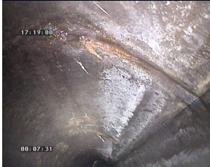
Foto: 27_1_9_16102008_172356_A.JPG 27,28m, Filtraciones por la junta
