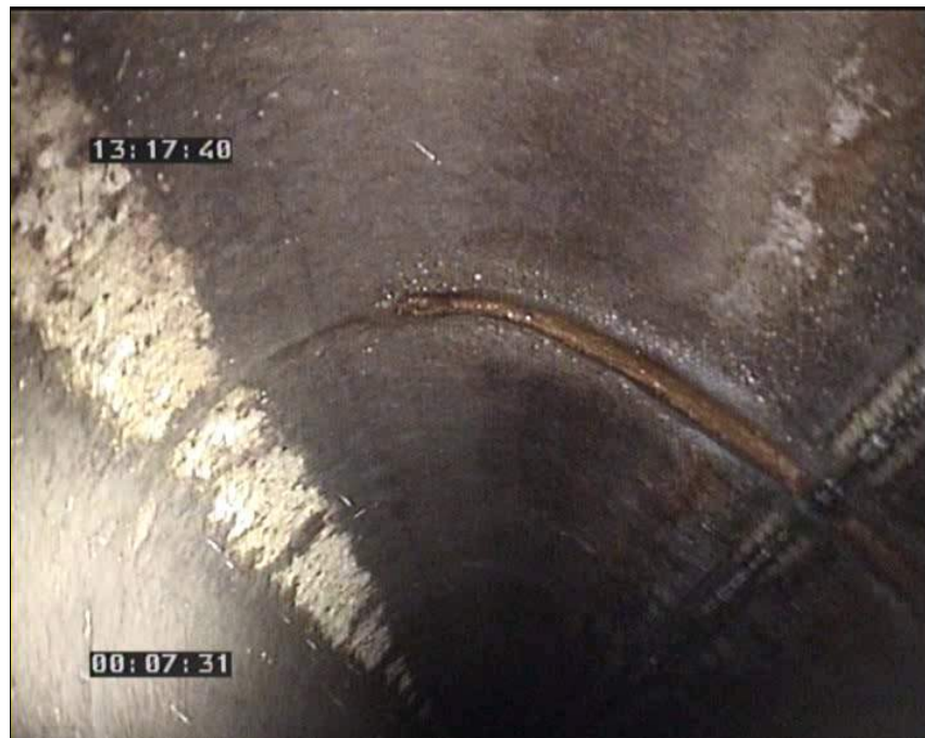
Foto: 26_1_2_16102008_132240_B.JPG 2,41m, Junta con filtraciones
