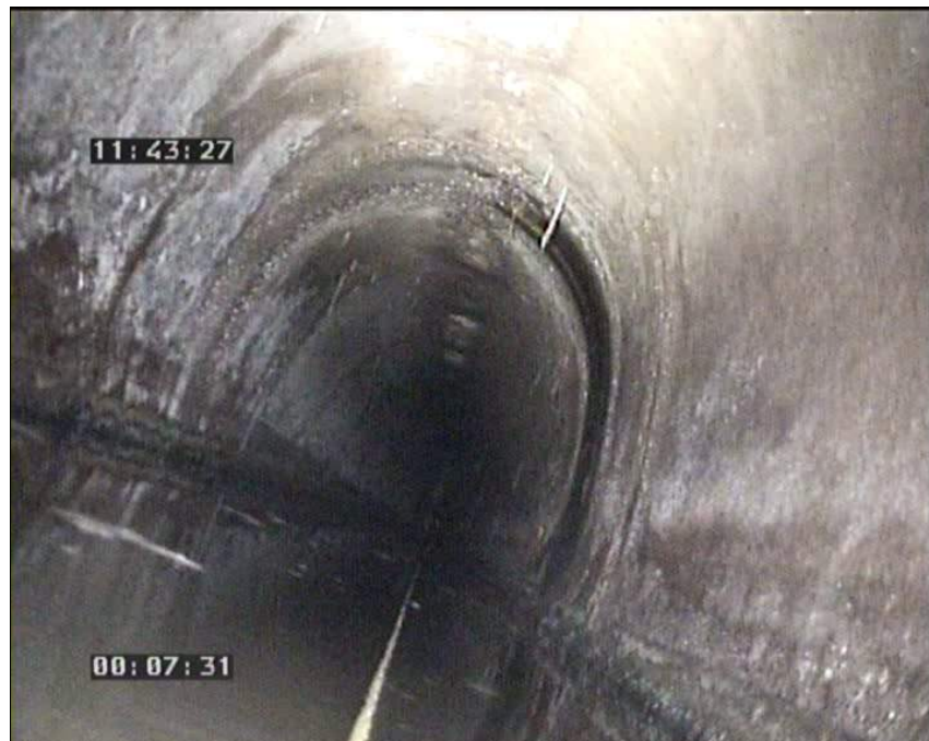
Foto: 23_1_12_16102008_114822_A.JPG 39,01m, Juntas con filtraciones
