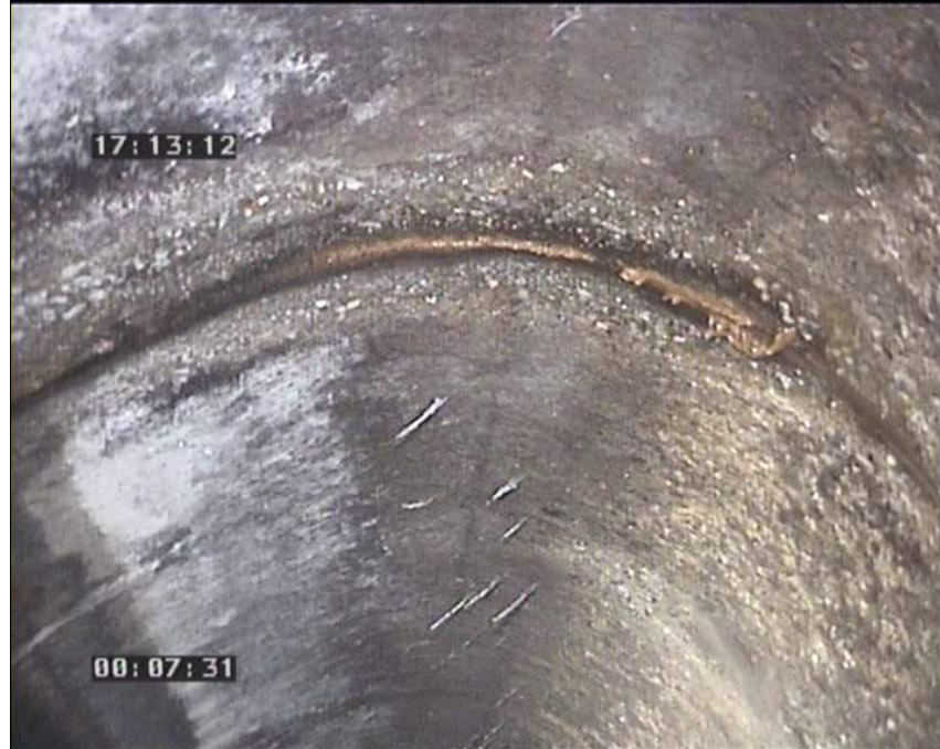
Foto: 27_1_6_16102008_171840_A.JPG 8,01m, Filtraciones por la junta
