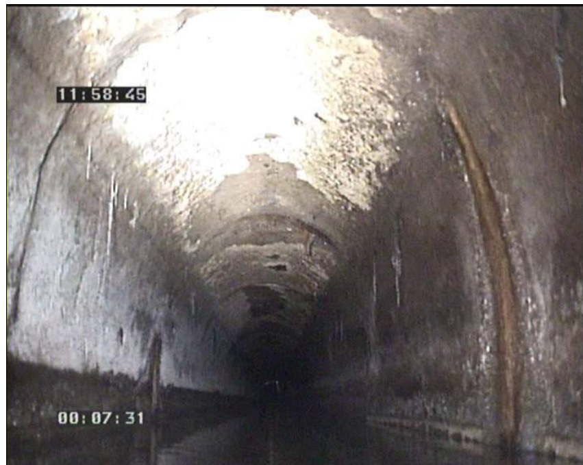
Foto: 24_1_5_16102008_120337_A.JPG 25,01m, Junta con filtraciones
