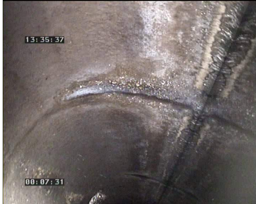
Foto: 26_1_9_16102008_134028_A.JPG 47,11m, Junta con filtraciones
