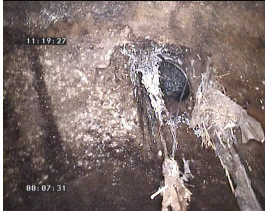
Foto: 23_1_2_16102008_112528_A.JPG 0,06m, Tubo entrocado en hastial derecho
