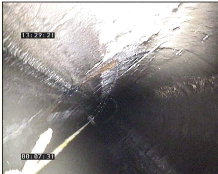
Foto: 26_1_7_16102008_133410_B.JPG 37,04m, Junta descarnada
