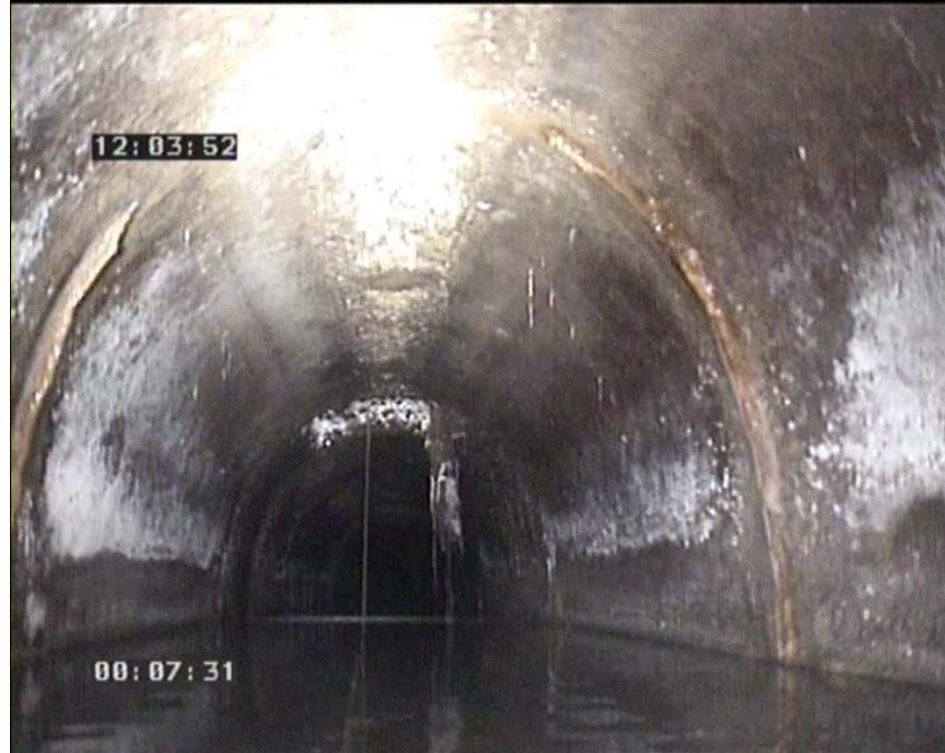
Foto: 24_1_8_16102008_120858_A.JPG 45,48m, Junta con filtraciones a ambos lados
