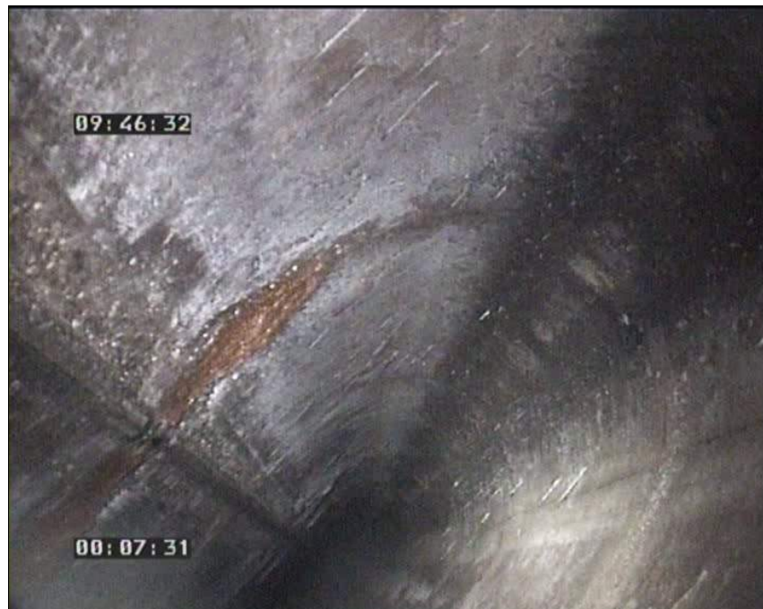
Foto: 22_1_2_16102008_095211_A.JPG 2,84m, Junta con filtraciones
