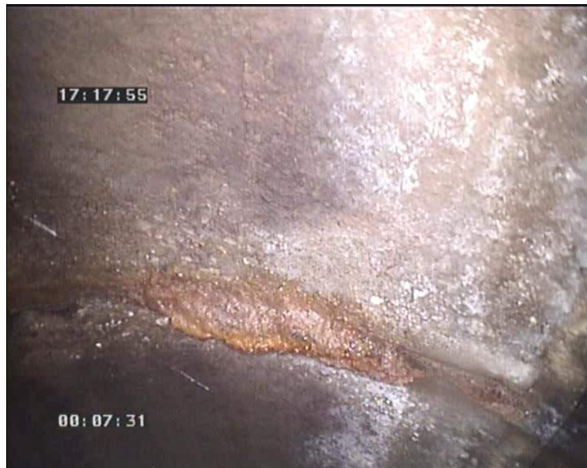
Foto: 27_1_8_16102008_172244_A.JPG 23,34m, Filtraciones por la junta
