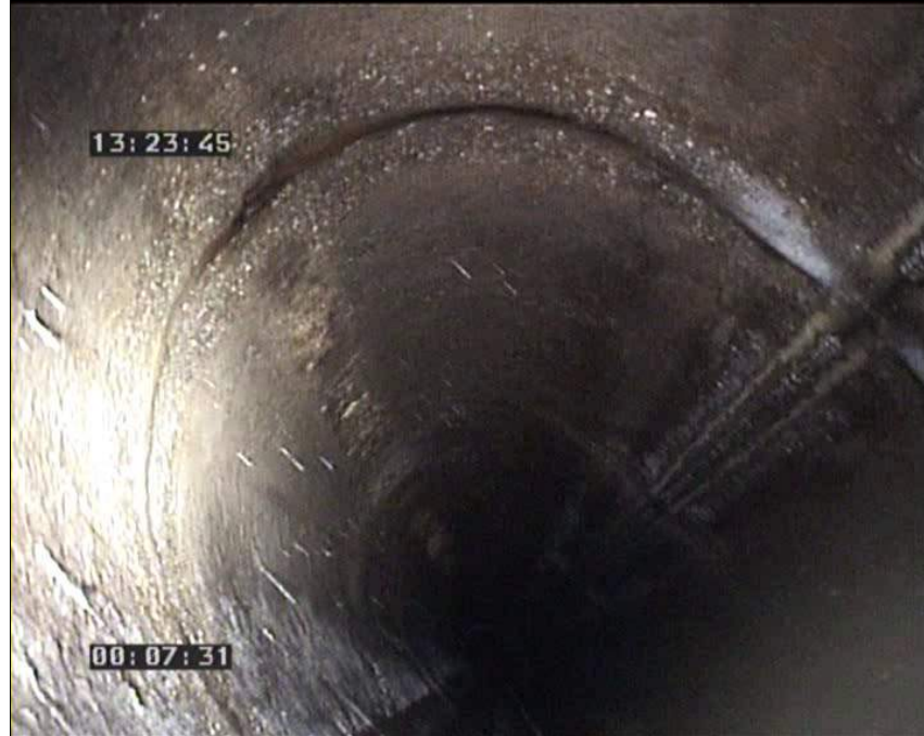
Foto: 26_1_5_16102008_132834_A.JPG 26,33m, Junta descarnada
