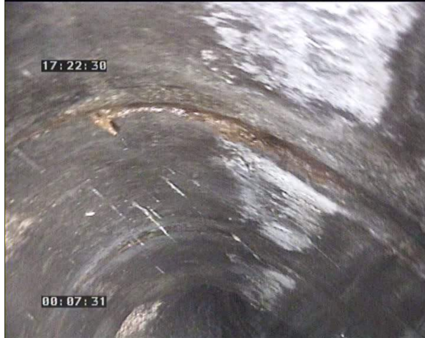
Foto: 27_1_12_16102008_172731_A.JPG 36,12m, Filtraciones por la junta
