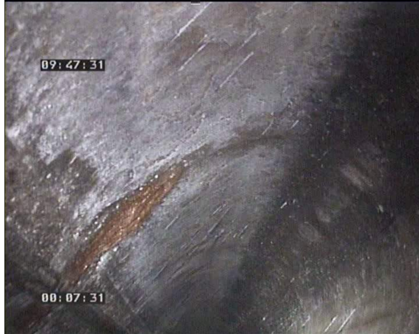
Foto: 22_1_2_16102008_095235_B.JPG 2,84m, Junta con filtraciones
