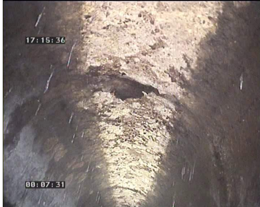
Foto: 27_1_7_16102008_172034_A.JPG 16,59m, Rotura en la clave
