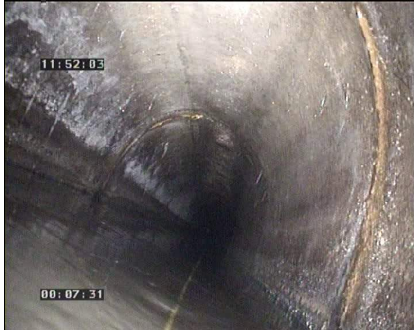
Foto: 24_1_2_16102008_115707_A.JPG 2,8m, Junta con filtraciones
