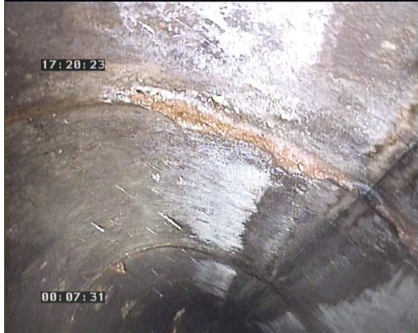
Foto: 27_1_10_16102008_172512_A.JPG 30,92m, Filtraciones por la junta
