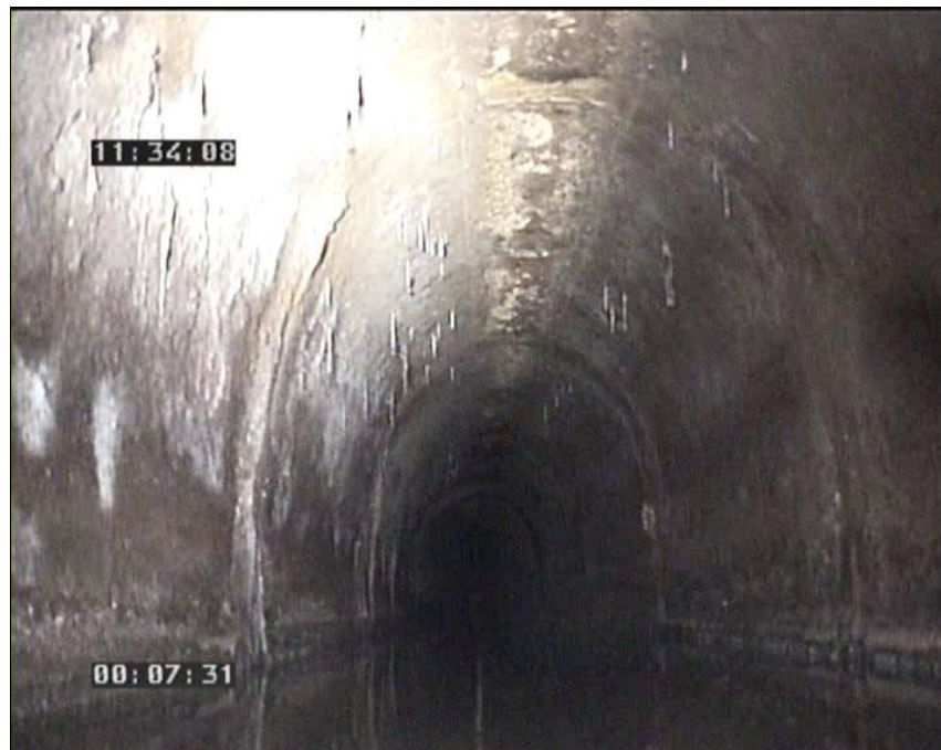
Foto: 23_1_8_16102008_113900_A.JPG 24,69m, Junta abierta hasta la clave
