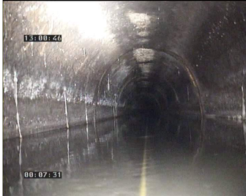
Foto: 25_1_2_16102008_130622_A.JPG 5,23m, Filtraciones por la junta
