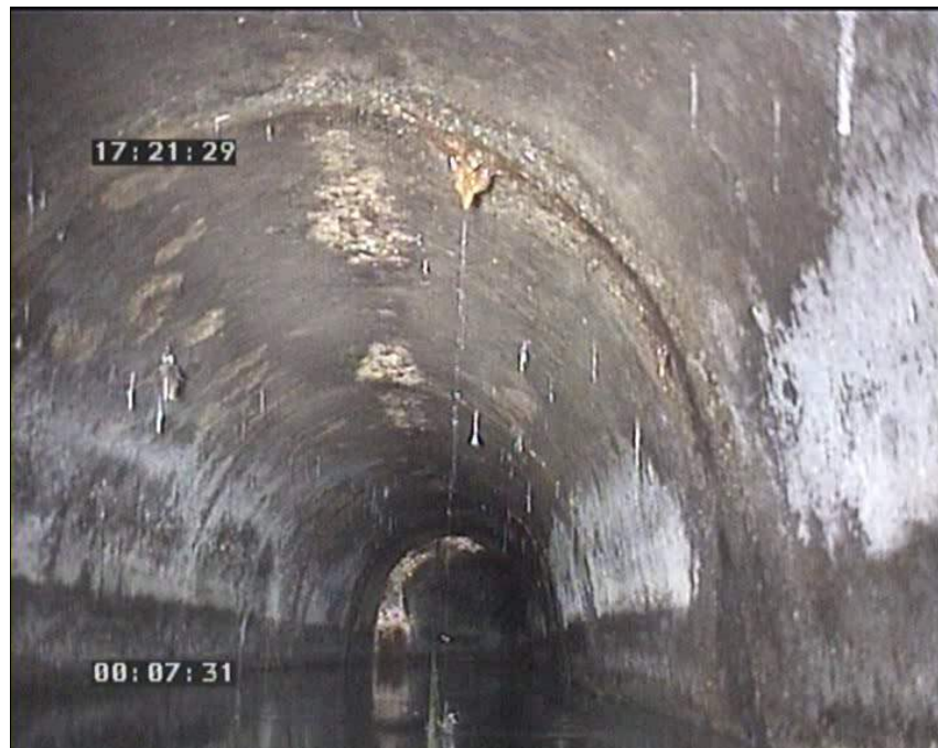
Foto: 27_1_11_16102008_172615_B.JPG 32,32m, Filtraciones por la junta
