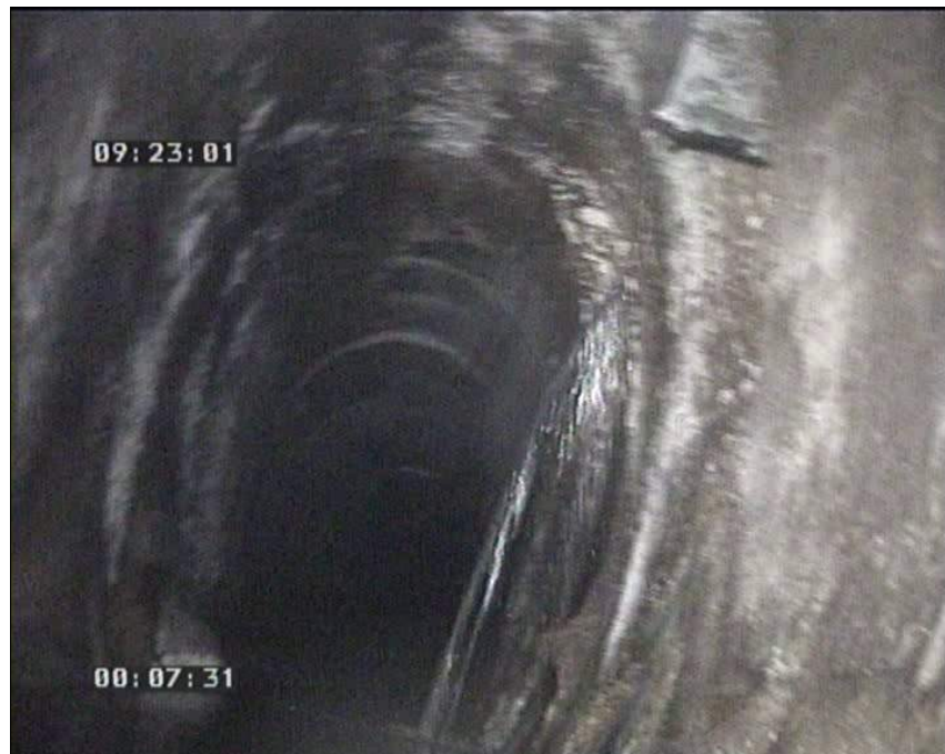
Foto: 21_1_2_16102008_092738_B.JPG 16,36m, Junta descarnada y con filtraciones
