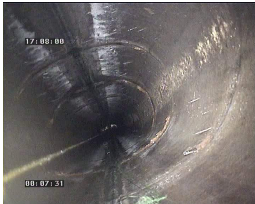
Foto: 27_1_4_16102008_171335_B.JPG 1,94m, Junta con filtraciones
