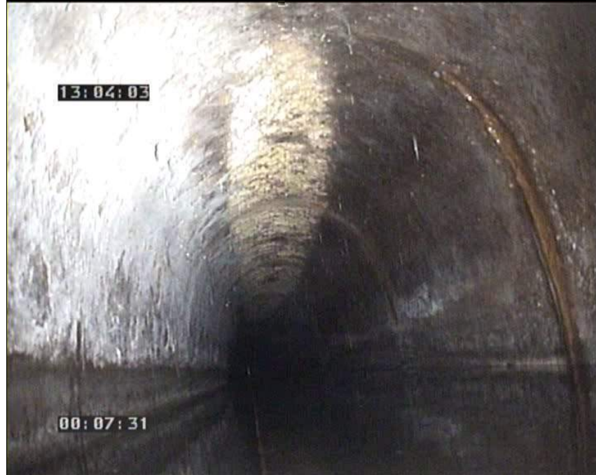
Foto: 25_1_3_16102008_130857_B.JPG 30,79m, Detalle de las filtraciones
