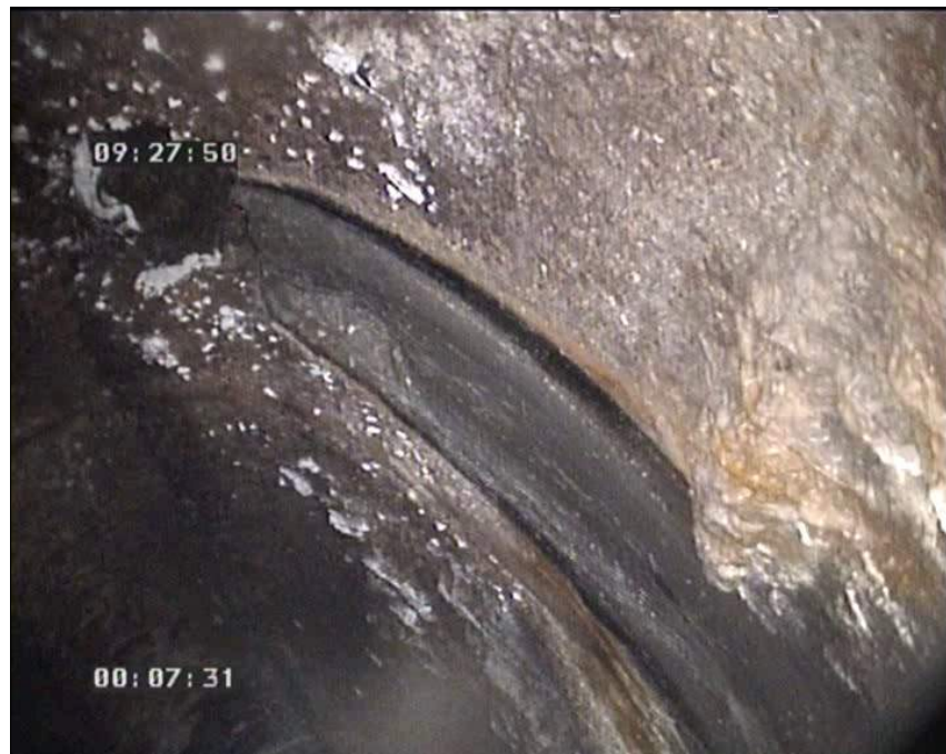
Foto: 21_1_4_16102008_093302_B.JPG 21,97m, Filtracion de agua por la junta
