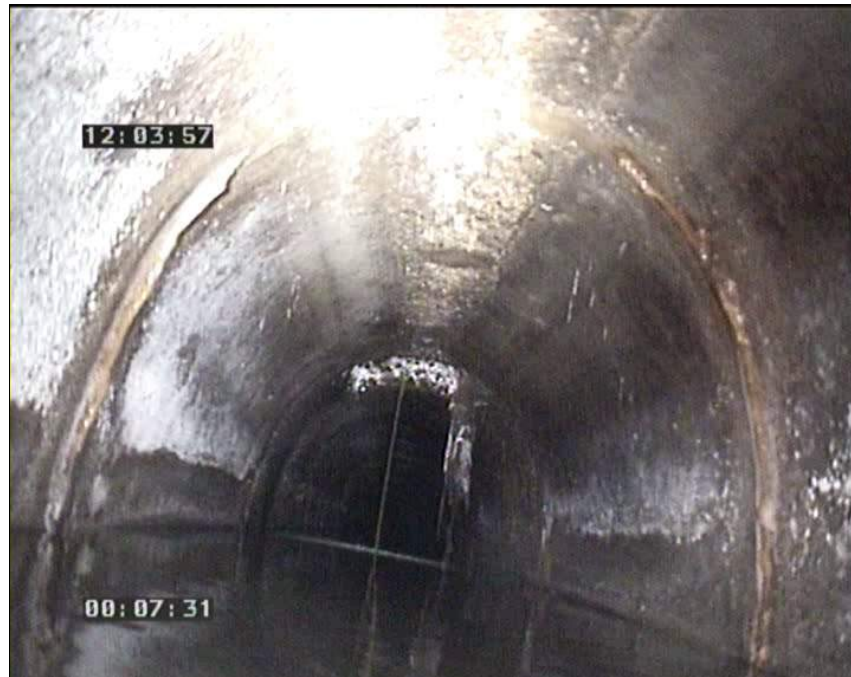
Foto: 24_1_8_16102008_120911_B.JPG 45,48m, Junta con filtraciones a ambos lados
