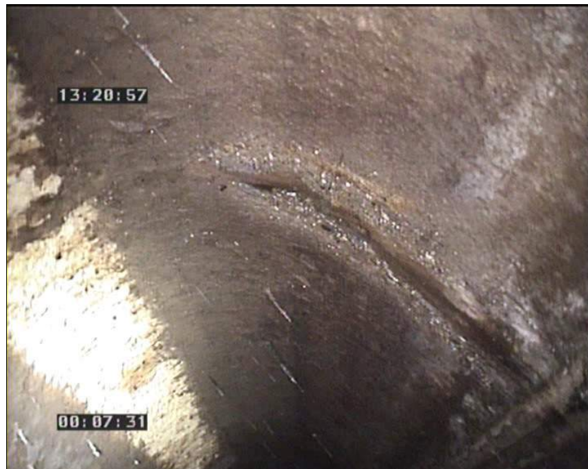
Foto: 26_1_4_16102008_132546_B.JPG 16,96m, Junta rota con filtraciones
