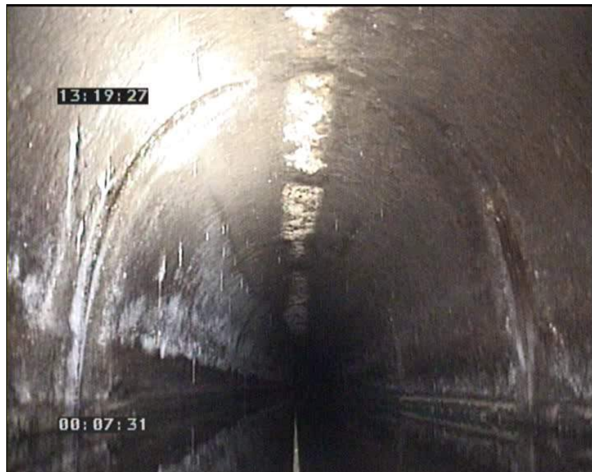
Foto: 26_1_3_16102008_132422_B.JPG 9,96m, Junta descarnada
