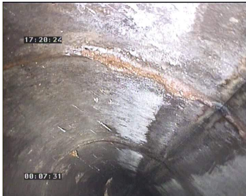
Foto: 27_1_10_16102008_172515_B.JPG 30,92m, Filtraciones por la junta
