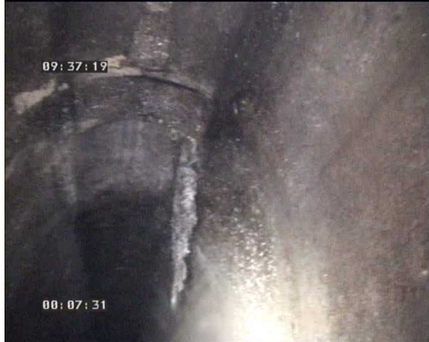
Foto: 21_1_7_16102008_094320_A.JPG 50,11m, Rotura en la clave
