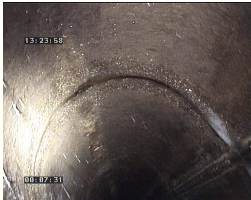
Foto: 26_1_5_16102008_132849_B.JPG 26,33m, Junta descarnada
