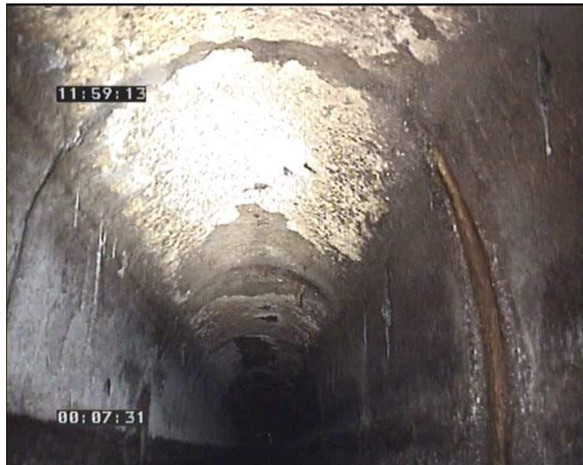
Foto: 24_1_5_16102008_120402_B.JPG 25,01m, Junta con filtraciones
