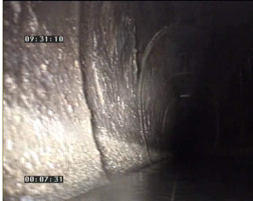
Foto: 21_1_5_16102008_093722_A.JPG 31,81m, Junta rota a lo largo del perímetro
