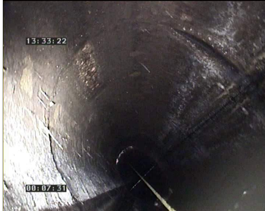
Foto: 26_1_8_16102008_133819_A.JPG 42,56m, Junta descarnada
