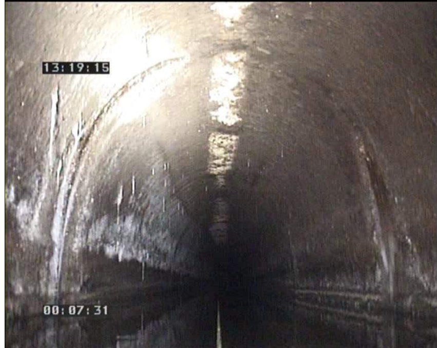
Foto: 26_1_3_16102008_132408_A.JPG 9,96m, Junta descarnada
