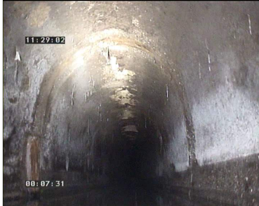
Foto: 23_1_5_16102008_113331_B.JPG 14,1m, Junta totalmente descarnada
