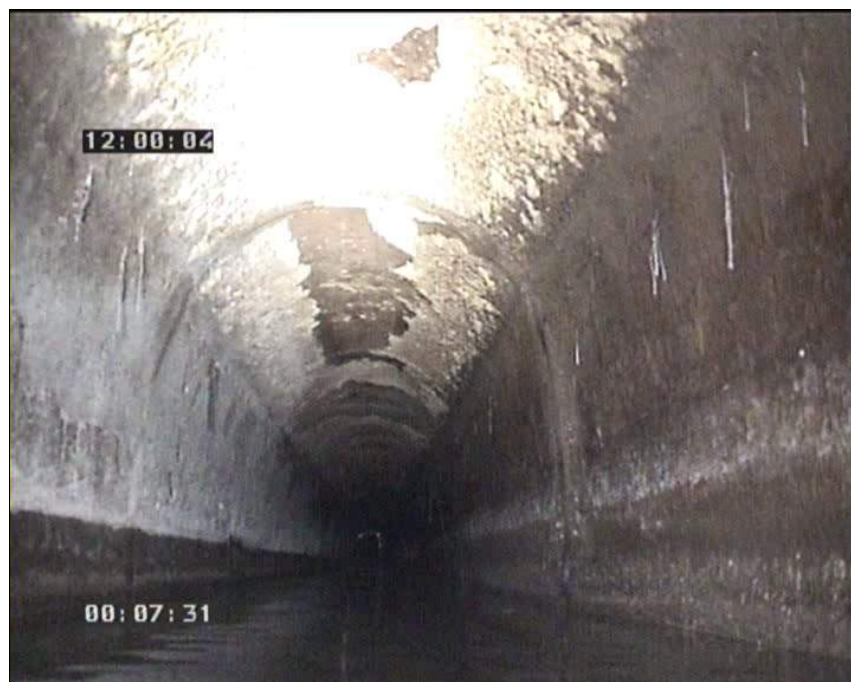
Foto: 24_1_6_16102008_120506_A.JPG 27,82m, Clave con desconchones
