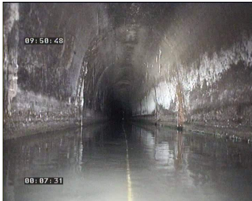
Foto: 22_1_3_16102008_095601_A.JPG 9,16m, Junta con filtraciones
