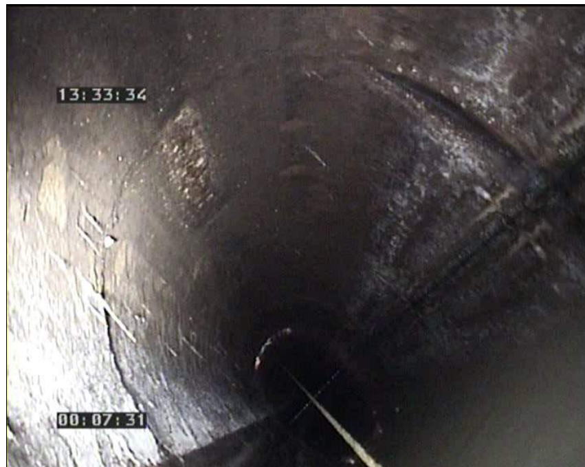
Foto: 26_1_8_16102008_133825_B.JPG 42,56m, Junta descarnada
