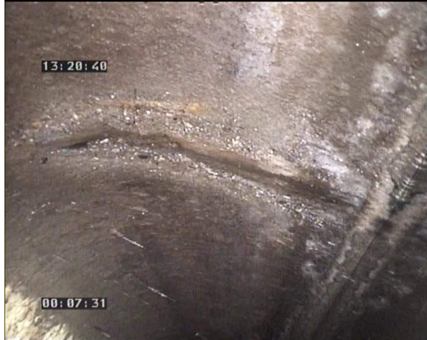
Foto: 26_1_4_16102008_132536_A.JPG 16,96m, Junta rota con filtraciones
