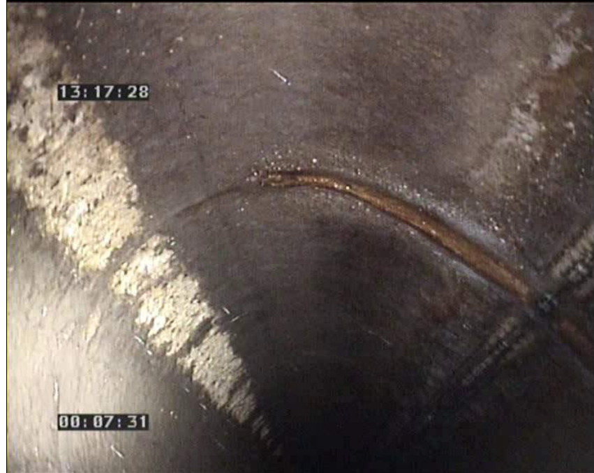
Foto: 26_1_2_16102008_132224_A.JPG 2,41m, Junta con filtraciones
