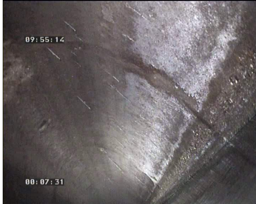
Foto: 22_1_5_16102008_100007_A.JPG 20,81m, Junta con filtraciones
