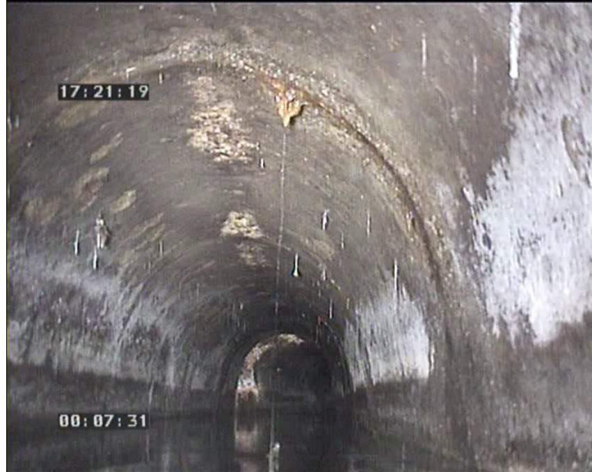
Foto: 27_1_11_16102008_172611_A.JPG 32,32m, Filtraciones por la junta
