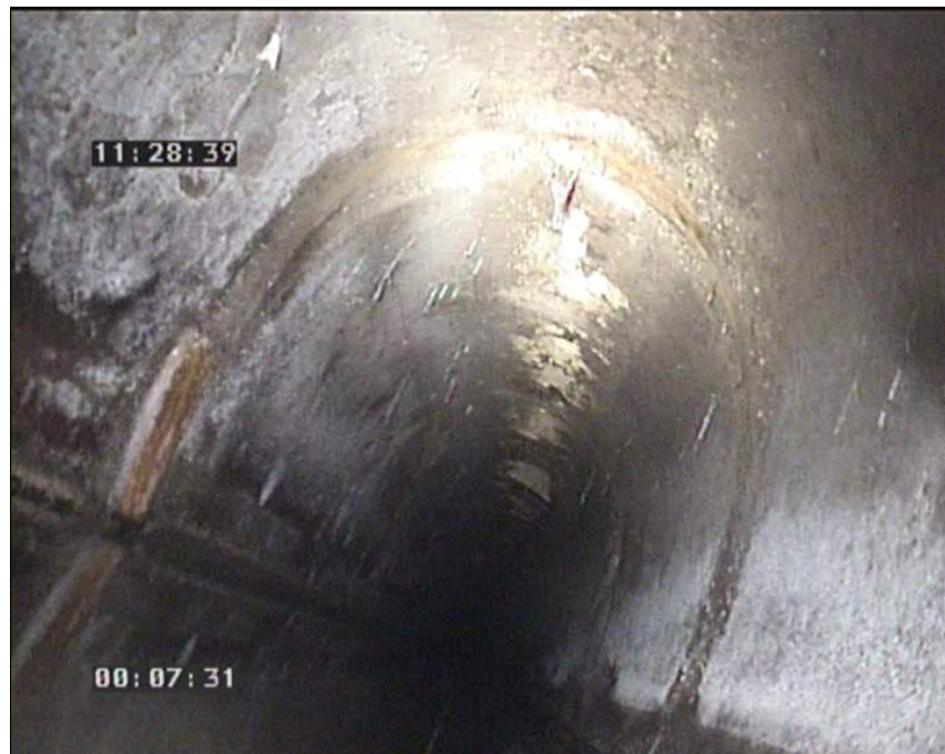
Foto: 23_1_5_16102008_113327_A.JPG 14,1m, Junta totalmente descarnada
