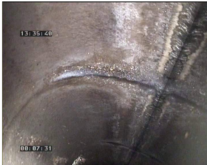
Foto: 26_1_9_16102008_134032_B.JPG 47,11m, Junta con filtraciones
