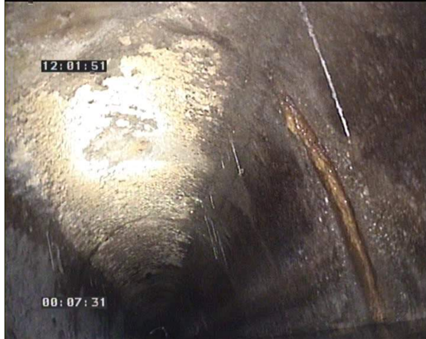
Foto: 24_1_7_16102008_120655_A.JPG 33,47m, Junta con filtraciones
