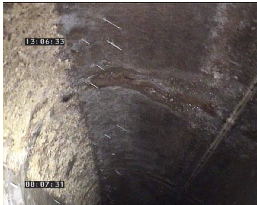
Foto: 25_1_4_16102008_131124_A.JPG 36,32m, Junta con rotura
