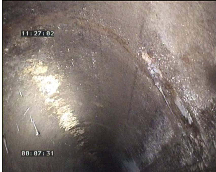
Foto: 23_1_4_16102008_113139_B.JPG 10,96m, Junta con filtraciones
