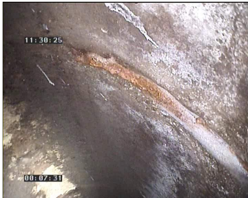
Foto: 23_1_6_16102008_113514_A.JPG 16,45m, Detalle de las filtraciones
