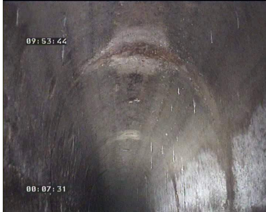
Foto: 22_1_4_16102008_095838_A.JPG 16,16m, Junta con filtraciones a la altura de la clave
