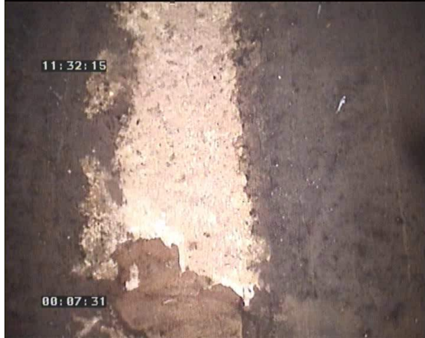
Foto: 23_1_7_16102008_113650_B.JPG 19,79m, Rotura en un punto de la clave
