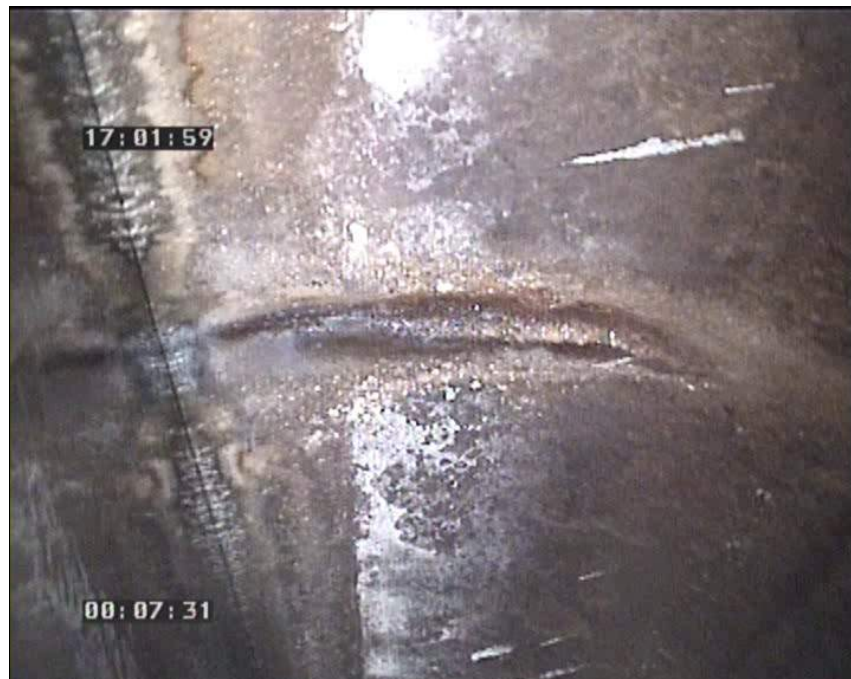
Foto: 27_1_3_16102008_170719_B.JPG 0,79m, Junta rota
