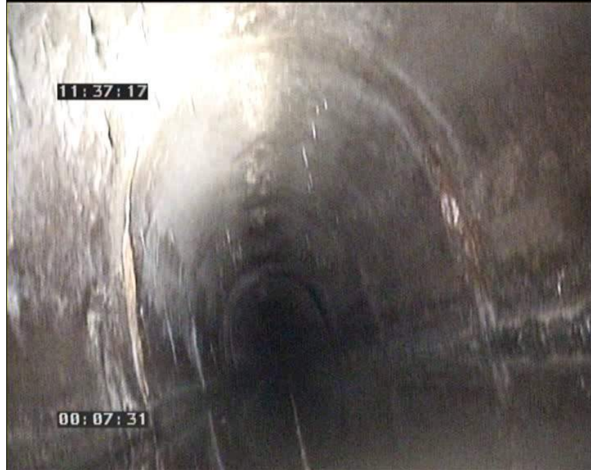
Foto: 23_1_10_16102008_114200_B.JPG 26,15m, Junta con filtraciones
