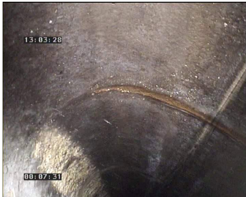
Foto: 25_1_3_16102008_130837_A.JPG 30,79m, Detalle de las filtraciones
