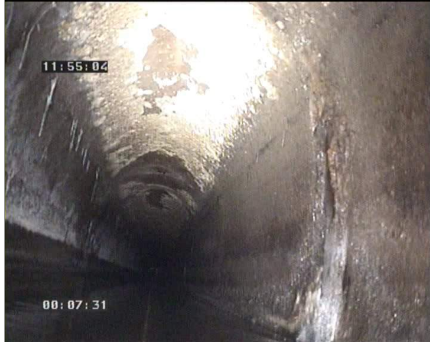
Foto: 24_1_3_16102008_115958_B.JPG 14,9m, Rotura de la junta hasta la altura de la clave
