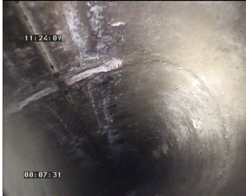
Foto: 23_1_3_16102008_112852_B.JPG 8,33m, Junta con filtraciones
