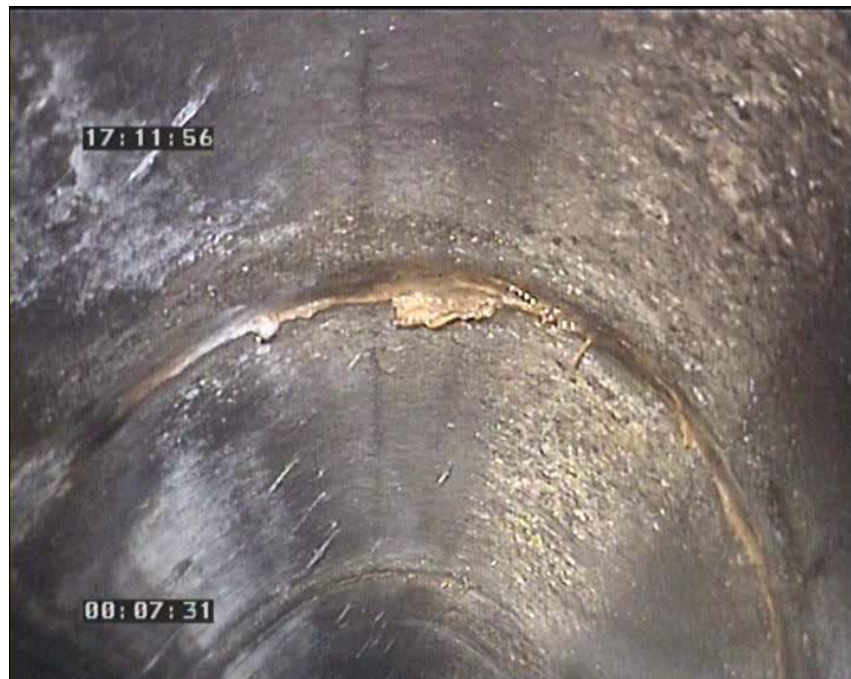
Foto: 27_1_6_16102008_171702_B.JPG 5,87m, Filtraciones por la clave
