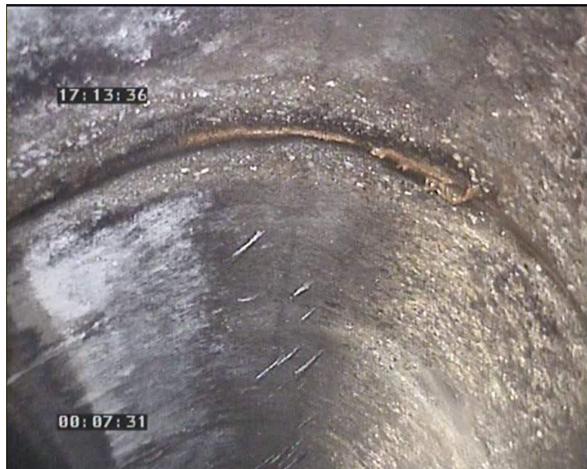
Foto: 27_1_6_16102008_171844_B.JPG 8,01m, Filtraciones por la junta
