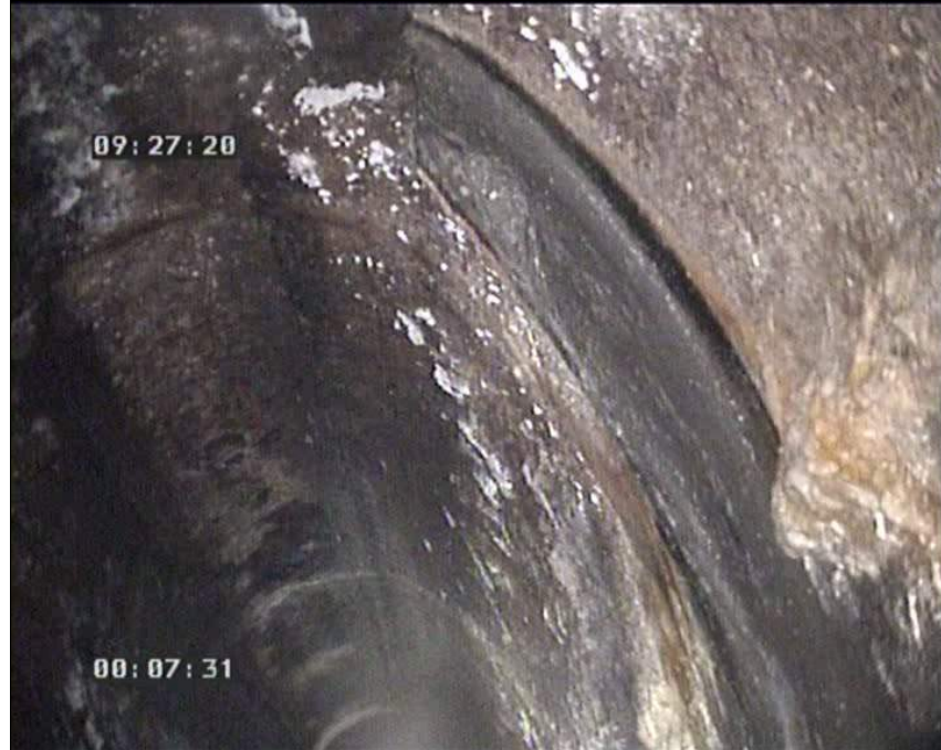
Foto: 21_1_4_16102008_093252_A.JPG 21,97m, Filtracion de agua por la junta
