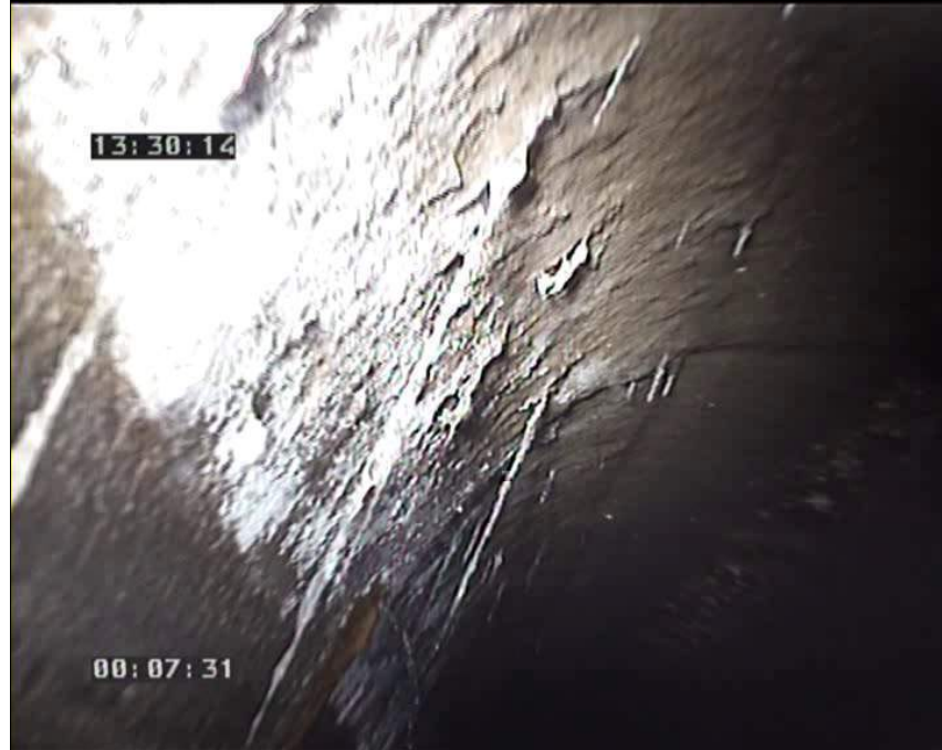
Foto: 26_1_7_16102008_133700_A.JPG 37,04m, Junta descarnada
