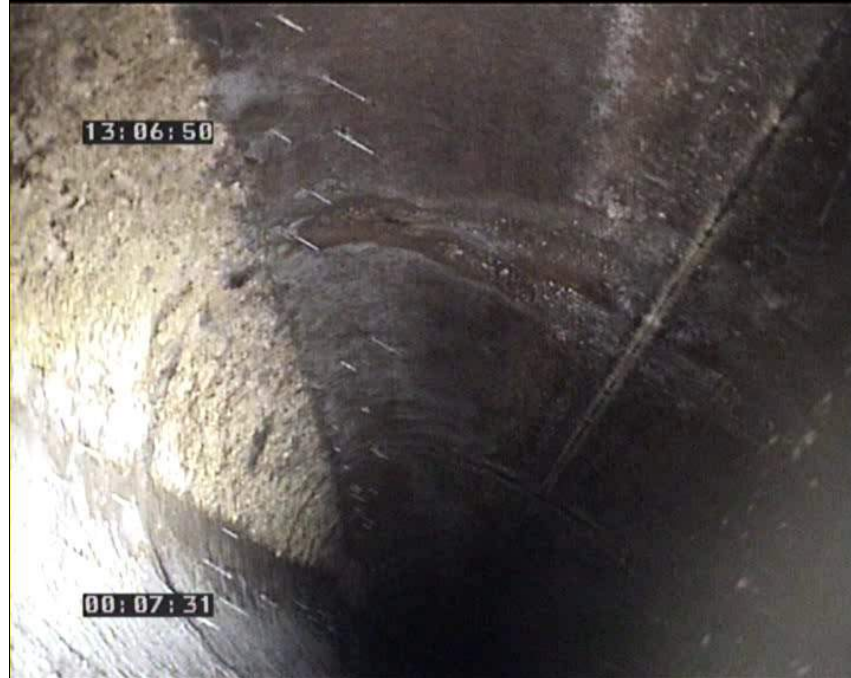
Foto: 25_1_4_16102008_131138_B.JPG 36,32m, Junta con rotura
