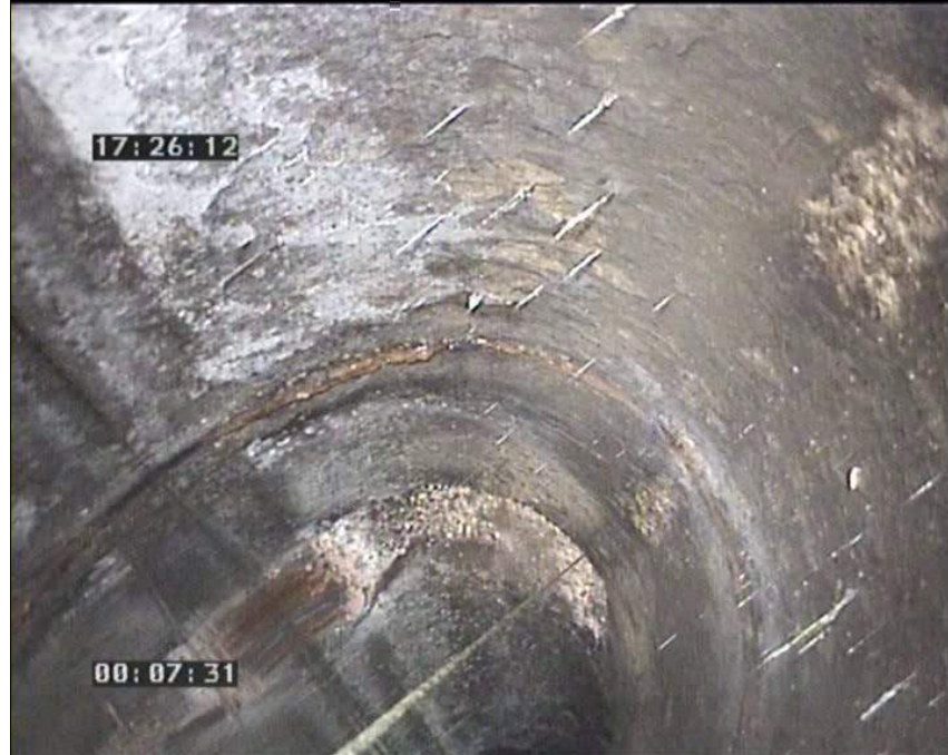
Foto: 27_1_14_16102008_173059_B.JPG 37,22m, Filtraciones por la clave
