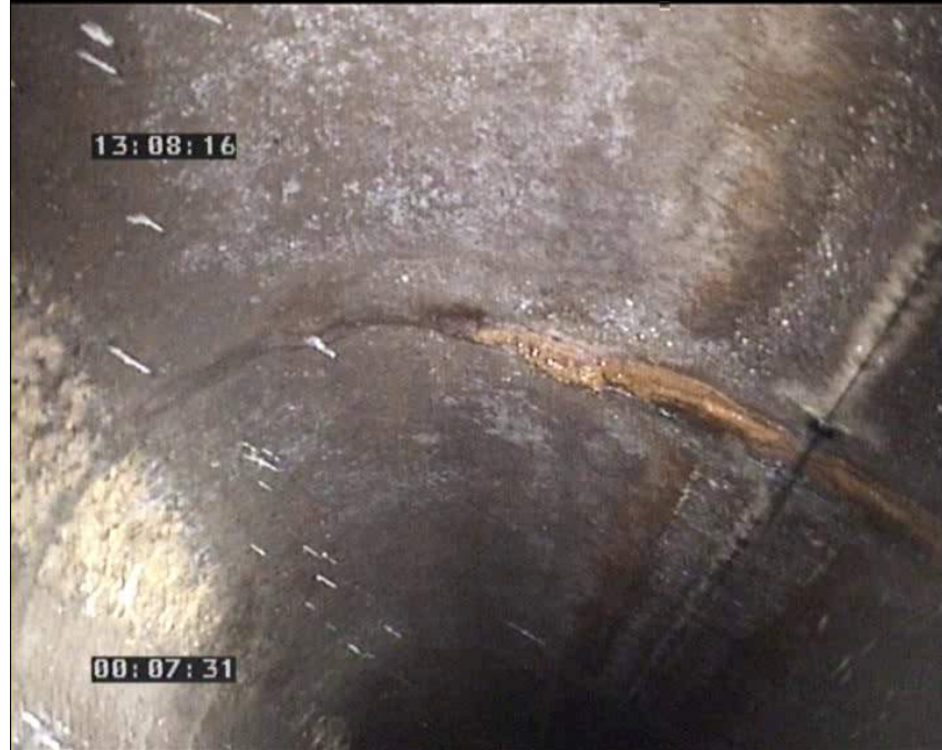
Foto: 25_1_5_16102008_131302_B.JPG 43m, Junta con filtraciones
