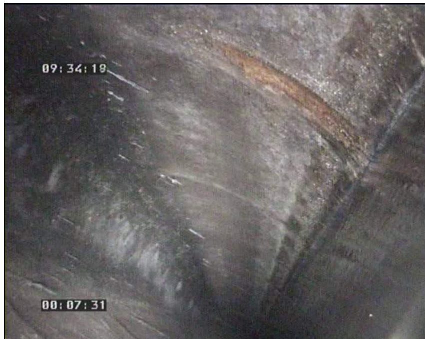
Foto: 21_1_6_16102008_093926_A.JPG 35,29m, Junta con filtraciones
