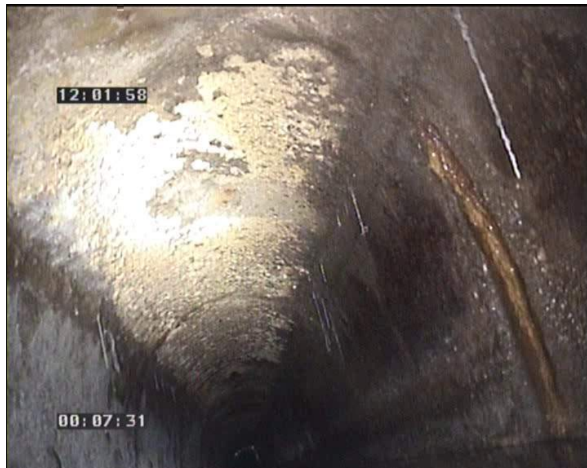
Foto: 24_1_7_16102008_120659_B.JPG 33,47m, Junta con filtraciones
