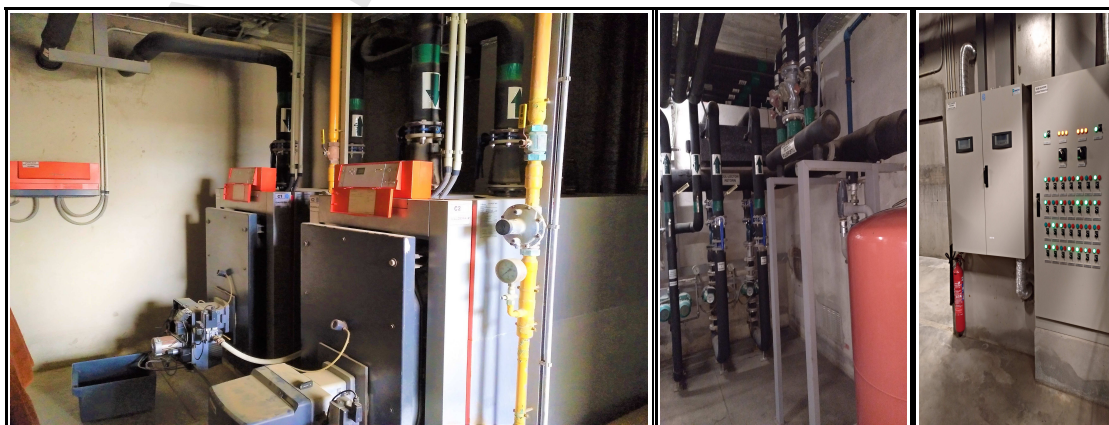
Figura 2.- Sala de calderes i sala tècnica de la Piscina municipal
