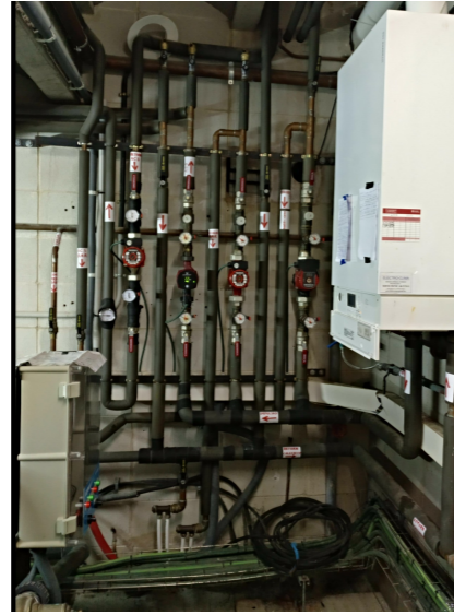
Figura 2.- Col·lector i caldera Estadi
