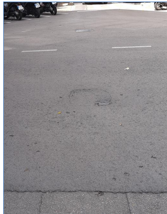
Esfonsament de la calçada
