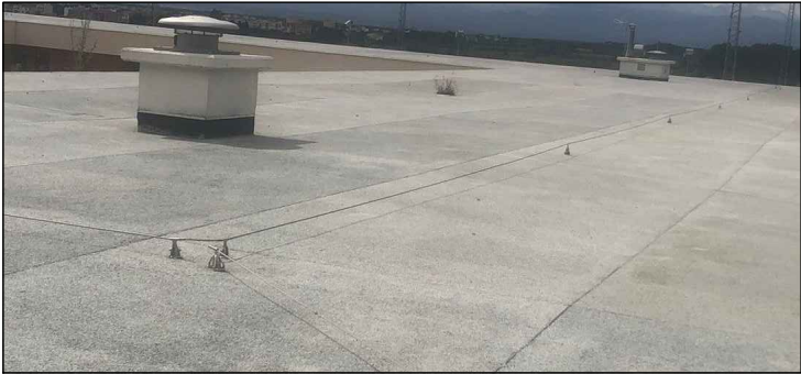
Línia de vida existent en coberta
