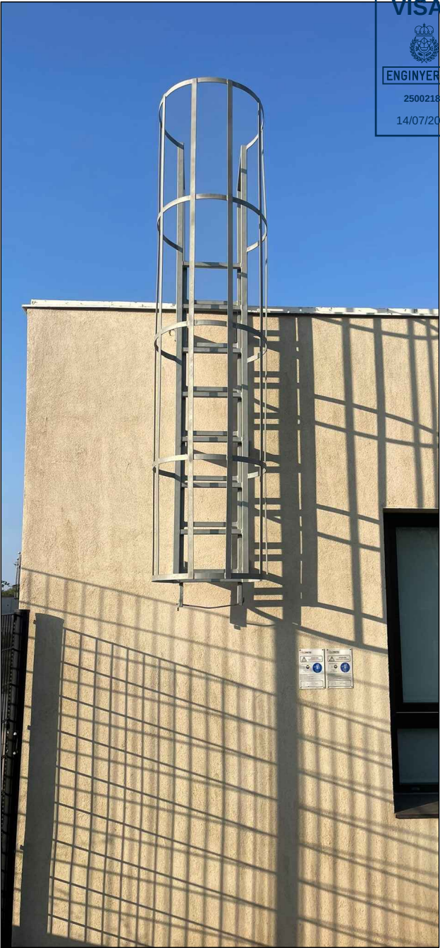
Escala de gat existent en façana
