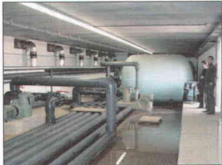
Foto 5. Filtres de la piscina d'onades soterrats.
