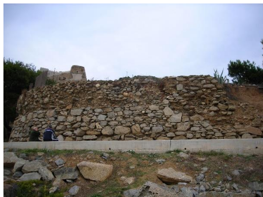
Fig.24. Vista de l'hort i el mal estat de conservació del mur U.E.128 (Font: invarquit gencat- foto de Jacob Casquete-2008)
