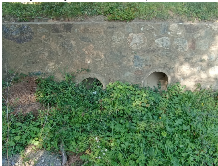
Imatge 18. Fotografies estructures hidràuliques escòrrec lateral
